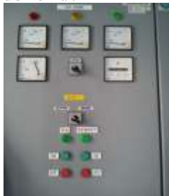
Gambar 3.12 ATS Tampak Bagian Luar yang terdapat di STO Tangerang
