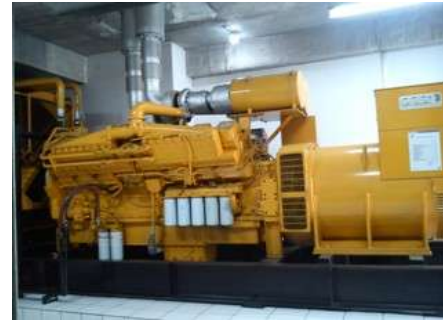
Gambar 2.8 Generator Set yang terdapat di STO Tangerang
