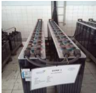
Gambar 3.6 Baterai yang terdapat di STO Tangerang
